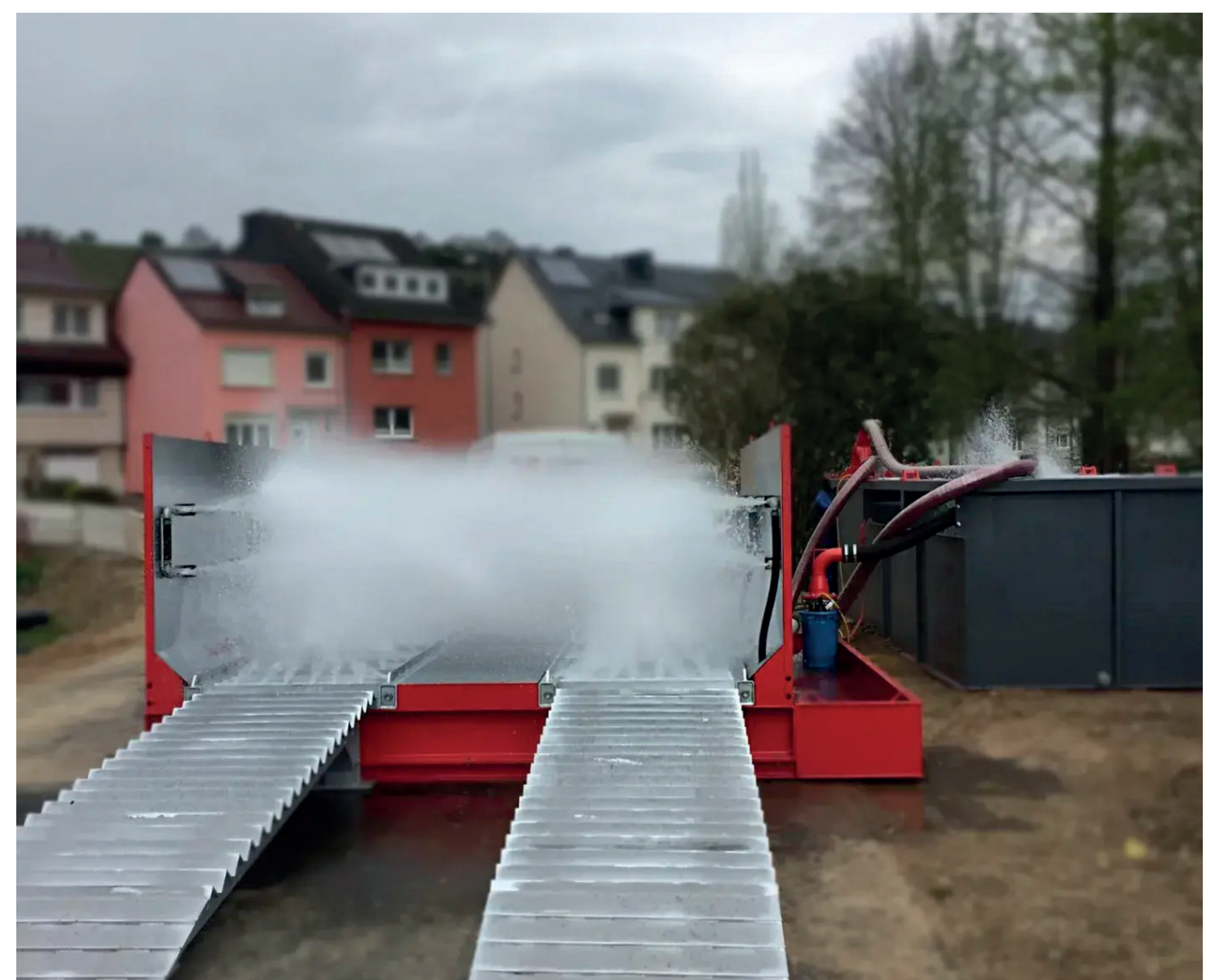
Reifenwaschanlagen reinigen Baufahrzeuge vor Verlassen der Baustelle
